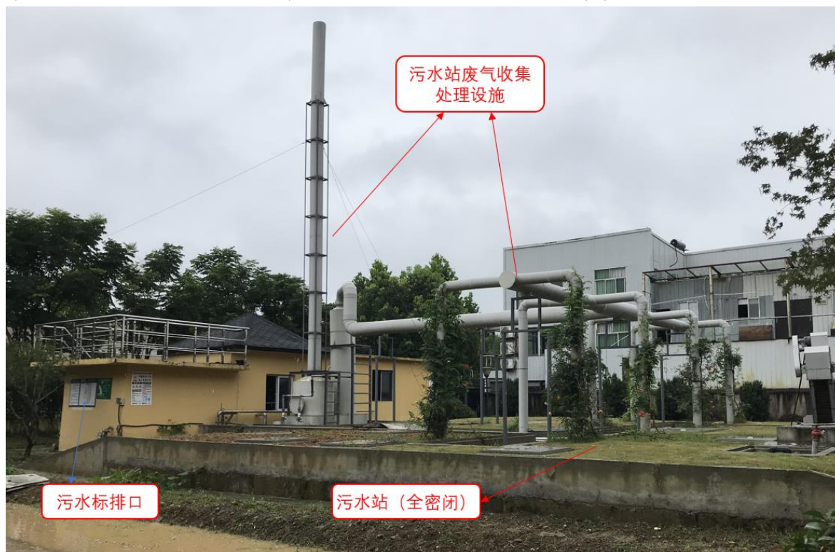
图4.1.1-3 污水站及其废气收集处理设施照片
